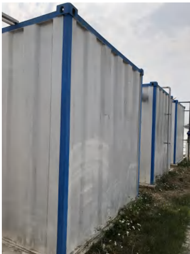
一体化处理设施
