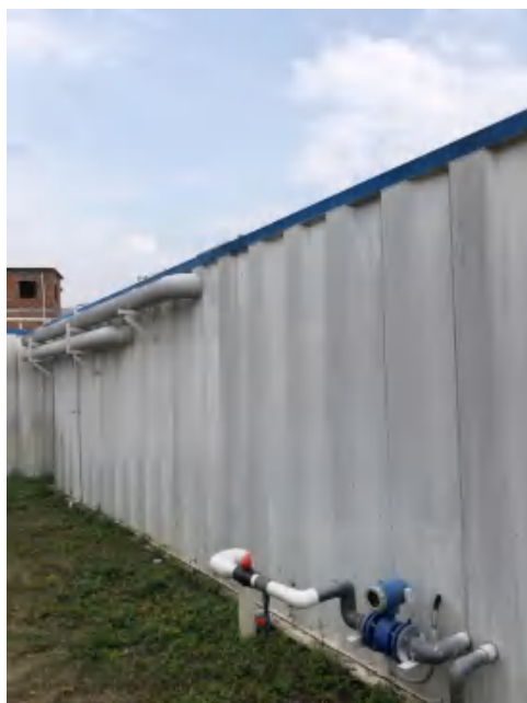
一体化污水处理设施
