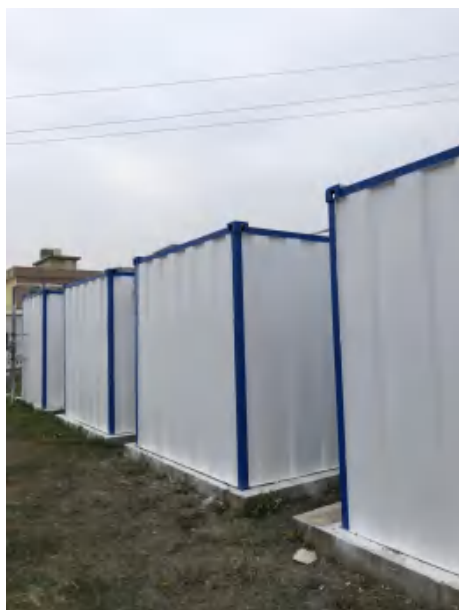
密闭污水处理设施
